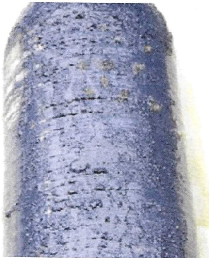
图 B.1 化学腐蚀(三级损伤)
